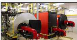
Chaudières à mazout et à gaz
