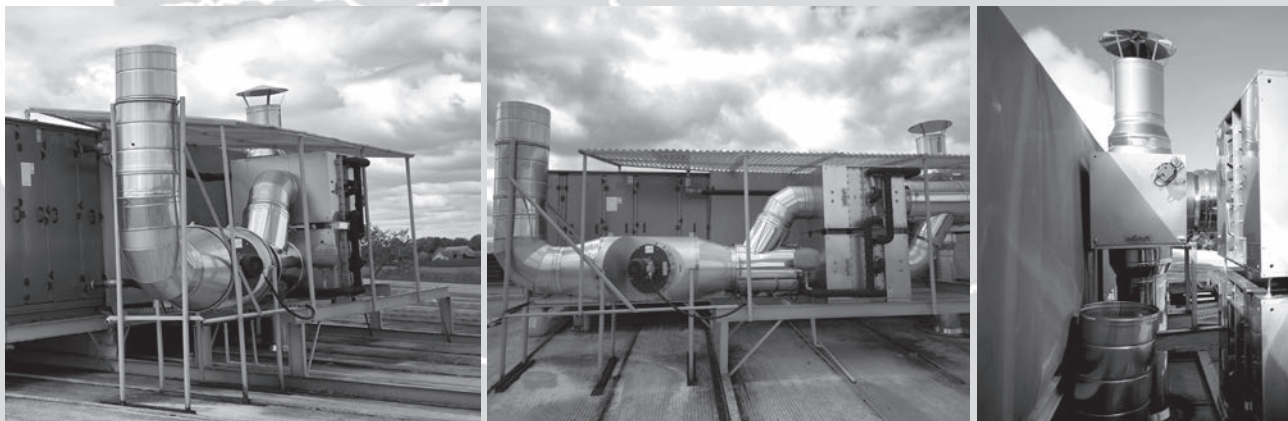
Instalace technologie na zpětné získávání tepla v sušičce zeleniny | Polsko
